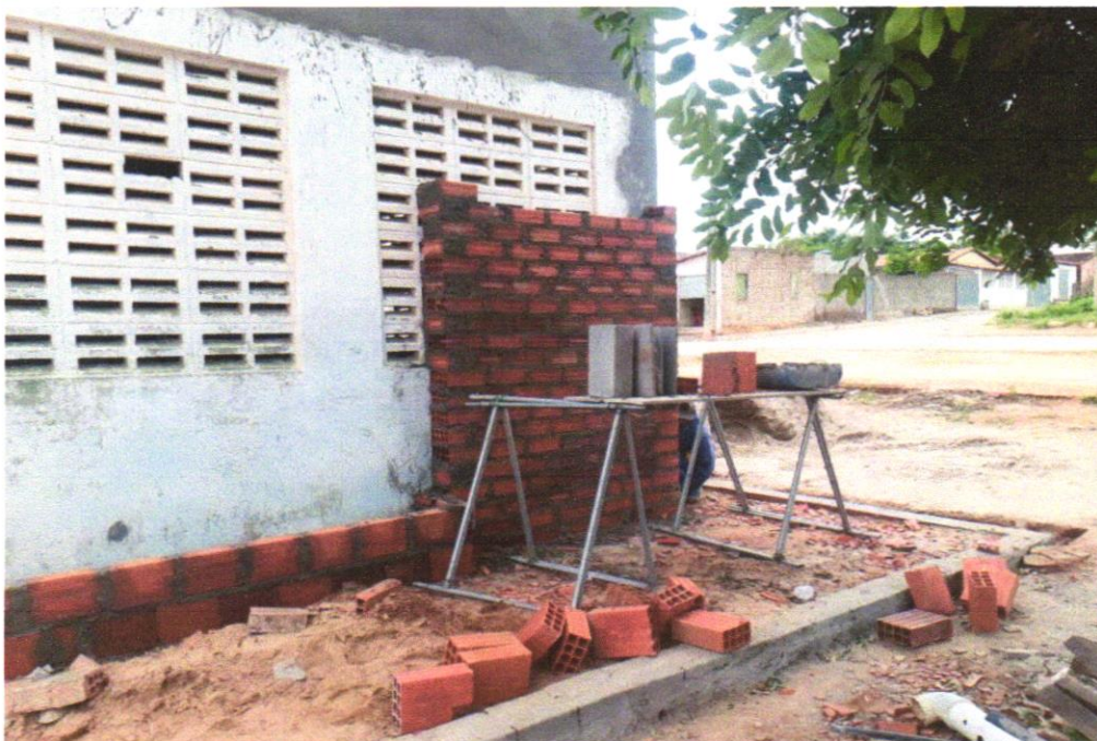
Foto 19 – ALVENARIA DE VEDAÇÃO DE BLOCOS CERÂMICOS FURADOS NA HORIZONTAL DE 9X19X29 CM (ESPESSURA 9 CM) E ARGAMASSA DE ASSENTAMENTO COM PREPARO EM BETONEIRA. AF_12/2021
